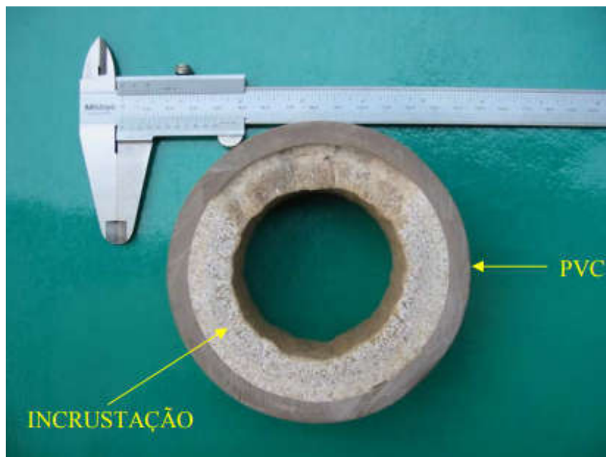
Figura 10 – Detalhe de tubulação incrustada
