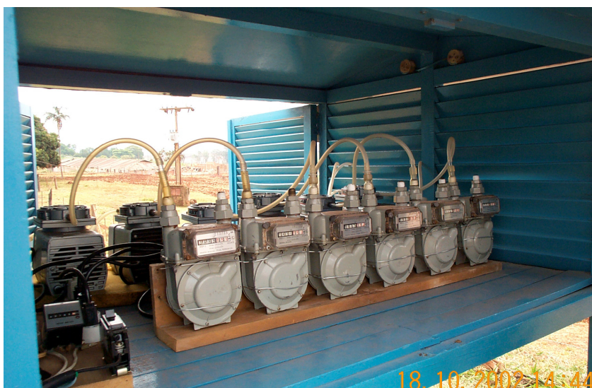
Figura 23. Vista interna da casinha de proteção do trem de amostragem, com as 6 bombas de vácuo e os 6 gasômetros calibrados.
