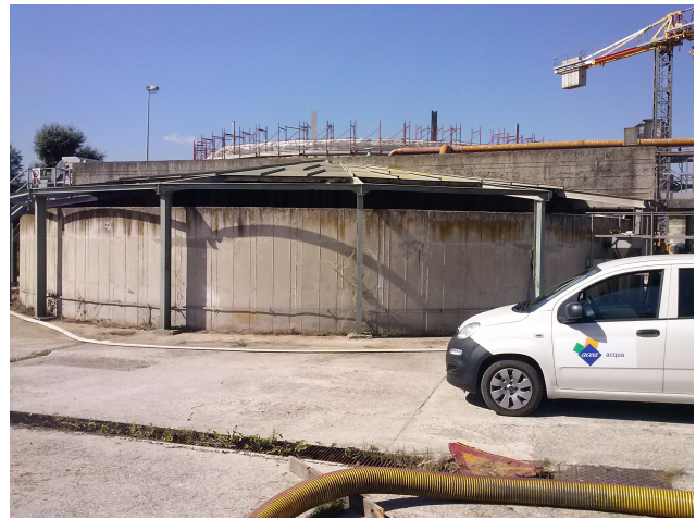
Immagine 13: Serbatoio di fango prima del trattamento, depuratore Roma Nord, settembre 2014.
