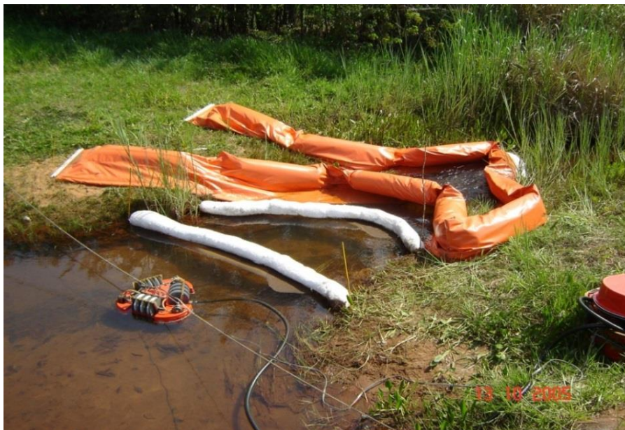
Figura 21 – Recolhimento do óleo utilizando skimmers a jusante da tubulação da rodovia Fonte: CETESB
