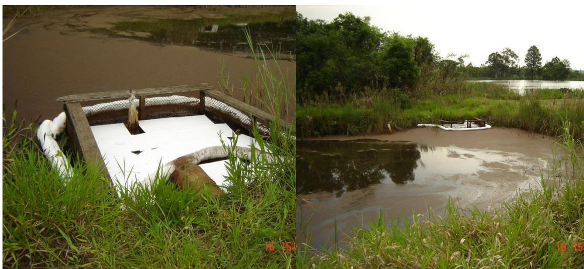
Figuras 22 e 23 – Mantas e barreiras absorventes e turfa protegendo a saída do tanque primário
