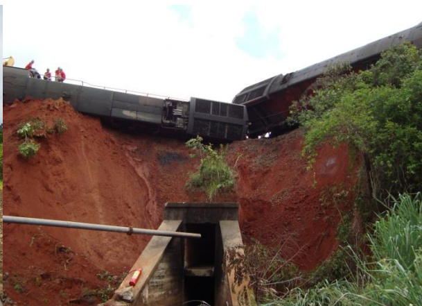
Figura 49 - Vagão pendurado no talude após acidente Fonte: CETESB
