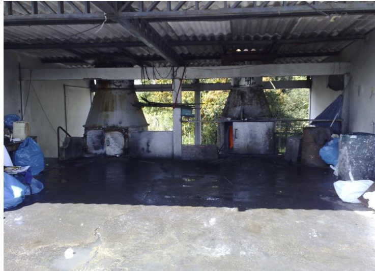
Figura 03 - Fornos utilizados para queima de resíduos hospitalares
