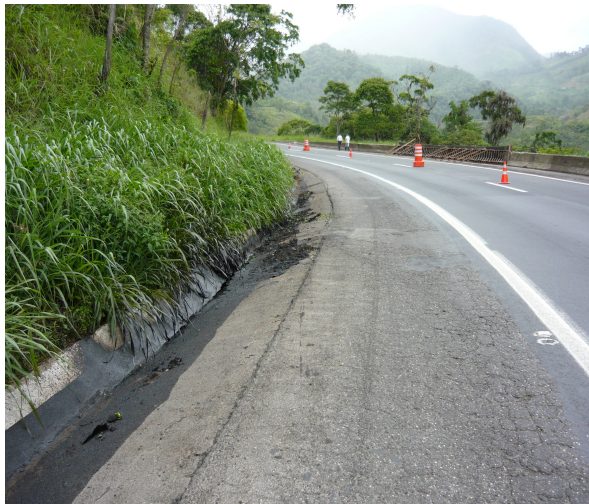
Foto 4 – Contaminação de sistema de drenagem de rodovia.
