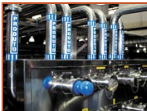
DETALHE DE UM PAINEL DE LANÇADORES DE PIG, COM UM PROJÉTIL PRONTO PARA LANÇAMENTO.
