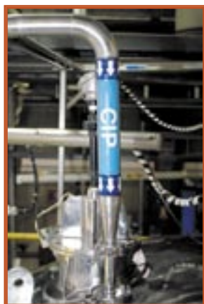
DETALHE DE UM REATOR COM ACOPLAMENTO PARA TUBULAÇÃO DE CIP
