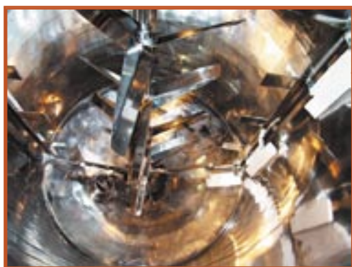
DETALHE INTERNO DE UM TANQUE PROVIDO DE RASPADORES PARA MAXIMIZAR A LIMPEZA.
